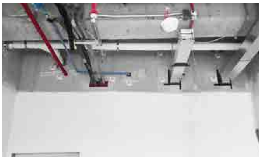
aplicada con 3M™ FireB arrier Masilla CP 25WB+ & 3M Fire Barrier Sellador FireDam 150+
